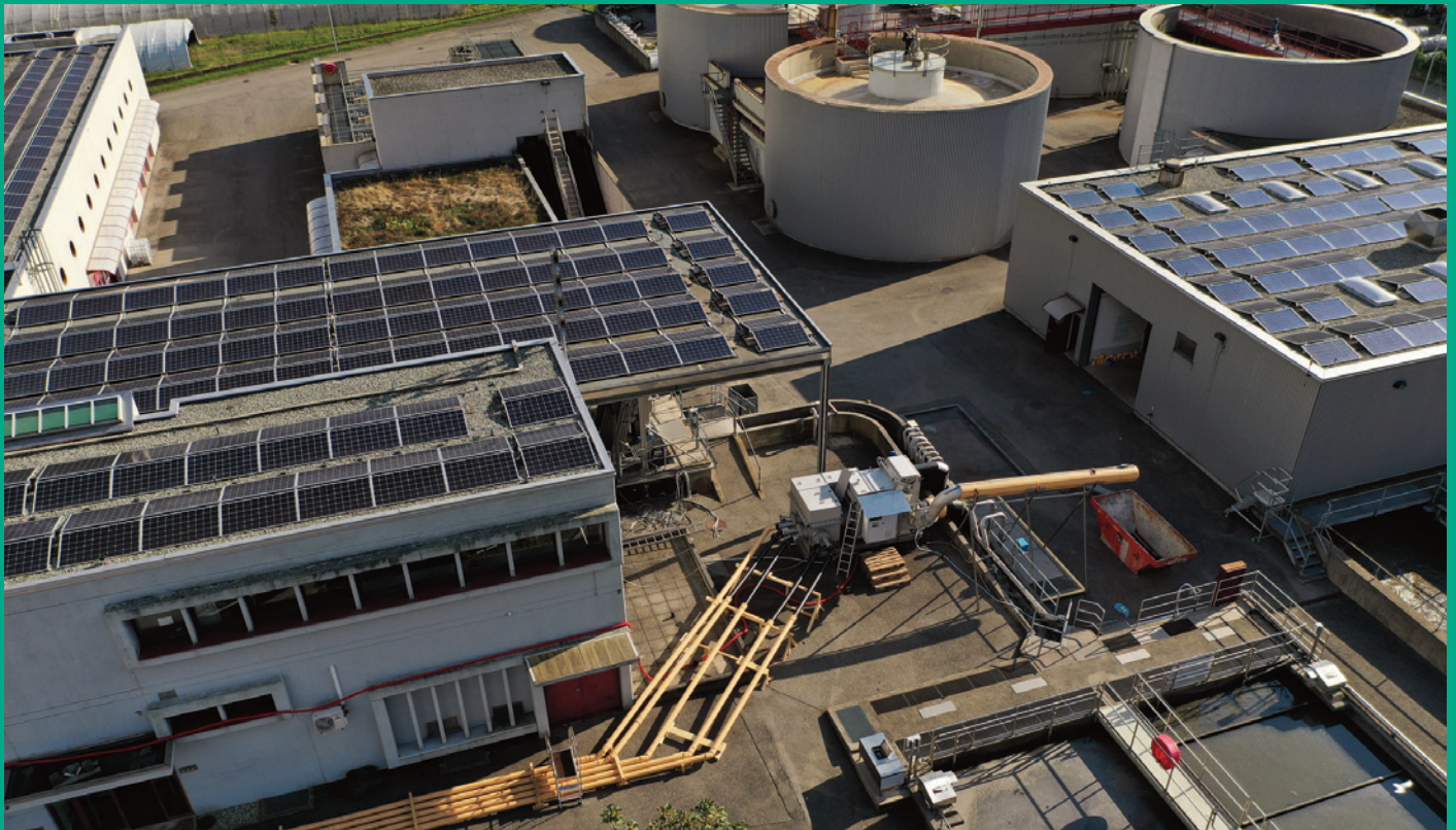
Mobiler Kompaktrechen im Einsatz
