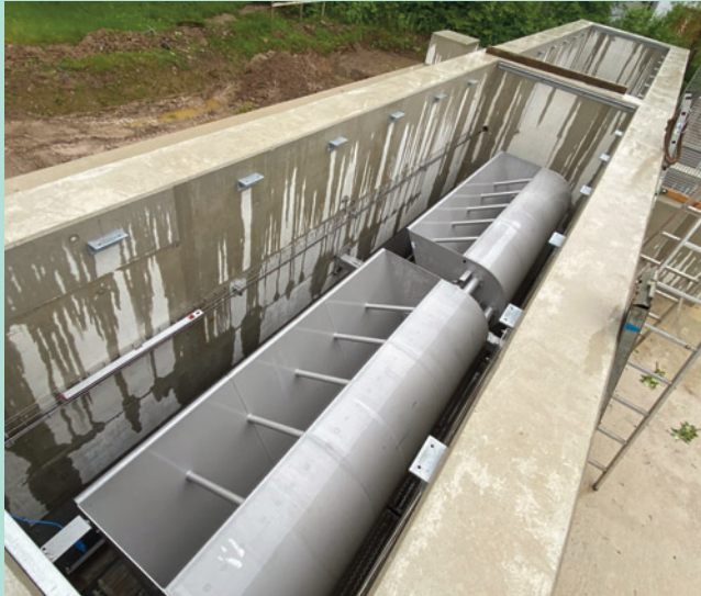
Steinhardt HydroSelf® Spülkippen in einem der insgesamt vier Spülkompartimente pro Becken – zu sehen sind die doppelt miteinander verstrebt Spültröge
