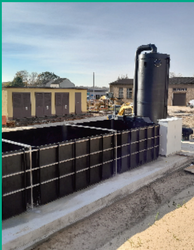
Abluftanlage mit Schaltschrank
