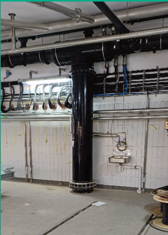
Verrohrung im Gebäude
